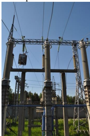
Рис.1 Изоляционные колонны ВОПТН NXVCT -230 фазы А,В,С
