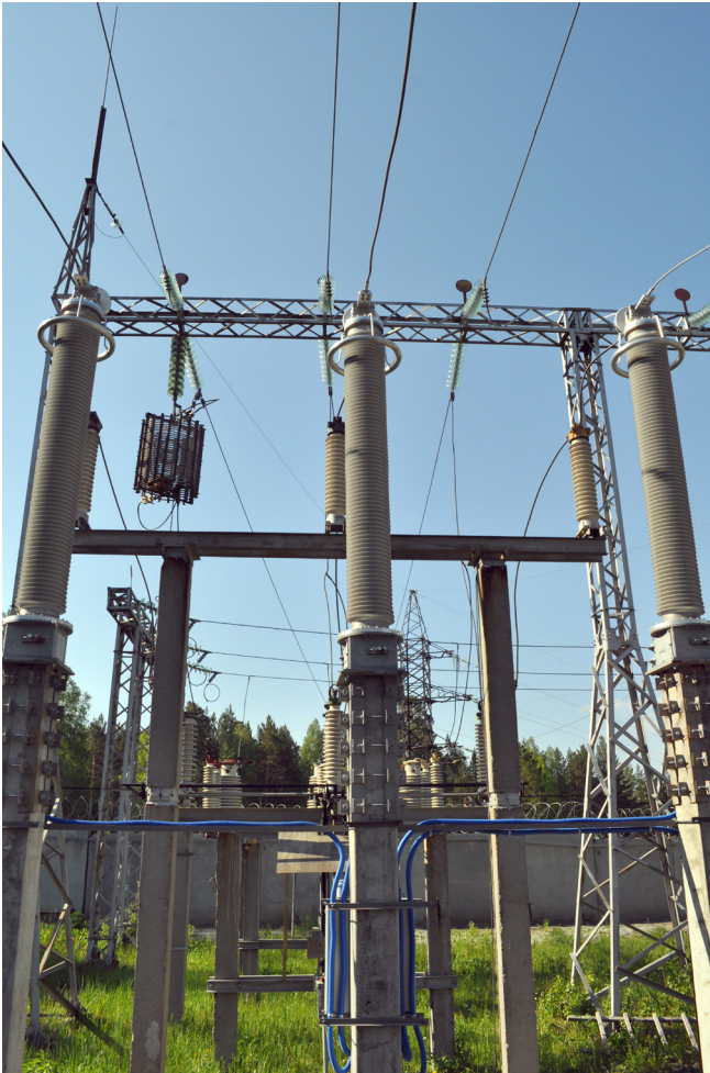
Рис. 1. Изоляционные колонны ВОПТН NXVCT -230 фазы А,В,С
